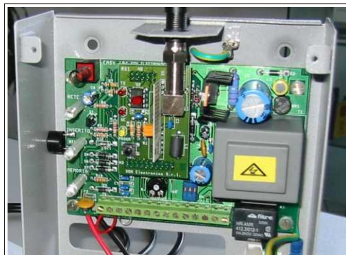
Il modulo MRX-01 installato nella centrale EA-104 (Centralina Easy)
